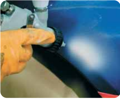
Aplique la base bicapa solamente en la zona donde se ha aplicado el aparejo.
